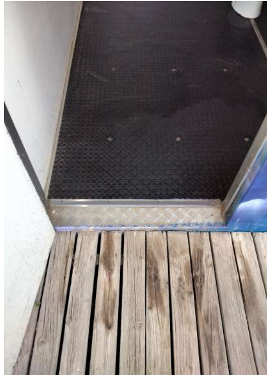
4.RESALTE EN ACCESO ASEO
